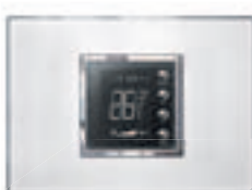
Comando do termostato
