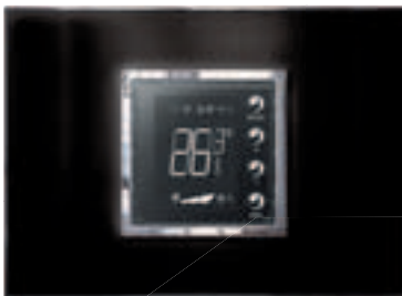
Comando do termostato
