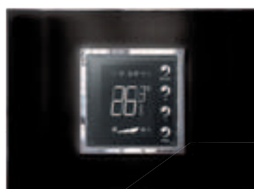
Comando do termostato
